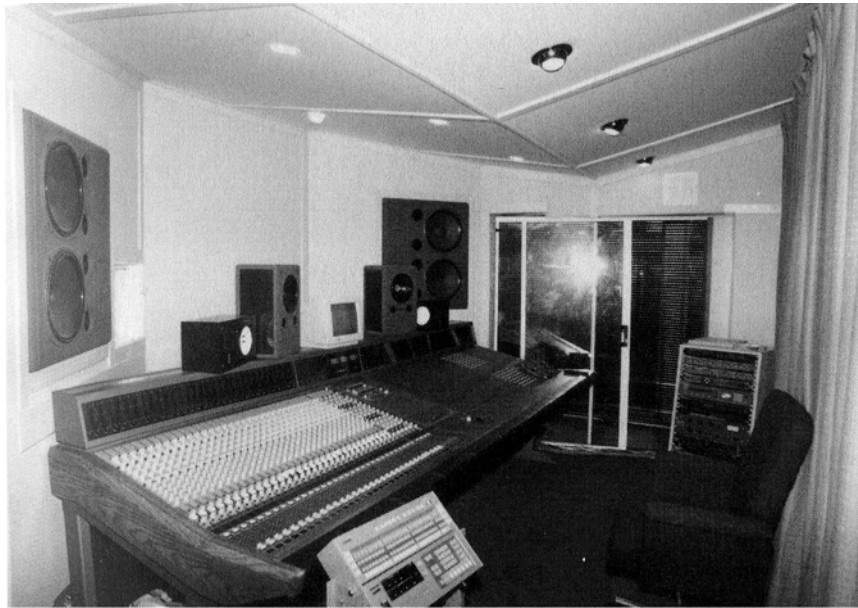
Фото 10. Project-студия для небольшой компании грамзаписи Revolver Records , Уолвергемптон ( Wolverhampton ), Великобритания. Контрольная комната была оборудована в бывшей комнате отдыха. Стеклопакетные раздвижные двери ведут в машинную комнату с кондиционерами воздуха, переделанную из оконной ниши. Пульт - Amek Mozart , мониторы - Tannoy ; плюс, конечно, Yamaha NS10 .
