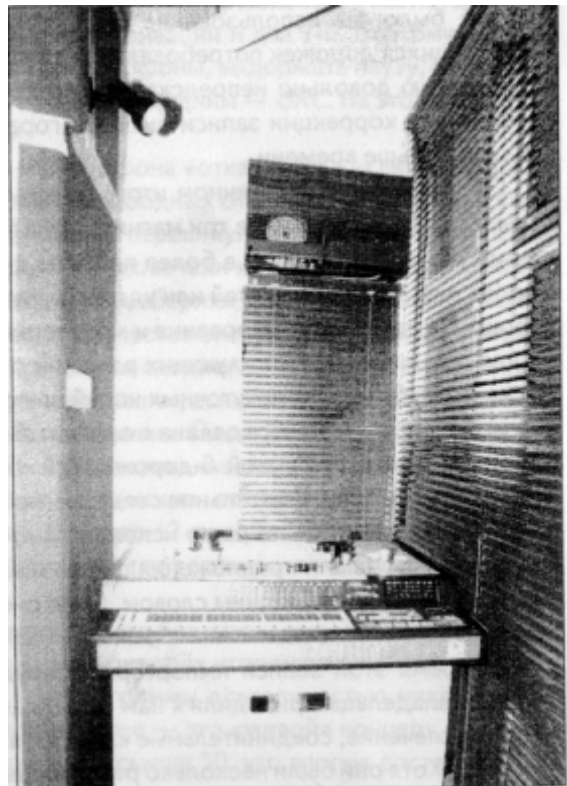
Фото 18. Цифровой магнитофон Sony 3324A в комнате с кондиционированием воздуха. Это помещение является «машинным залом» контрольной комнаты, показанной на рис.10-12.
